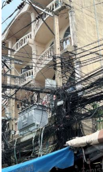
大量の電線 とてつもない量で衝撃でした
